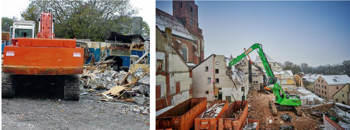
Abb. Anhang 20: Konventioneller Abbruch vs. kontrollierter Gebäuderückbau (links: Bayrisches Landesamt für Umwelt 2019, S. 6; rechts: Wabner 2021)
